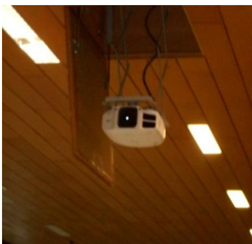
Remplacement du Beamer, mise en place de câble réseau, remplacement du tableau de prises électriques, système de présentation sans fil, émetteur HD : Facturation Fr. 12'040.-
